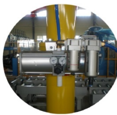
增压稳压系统
